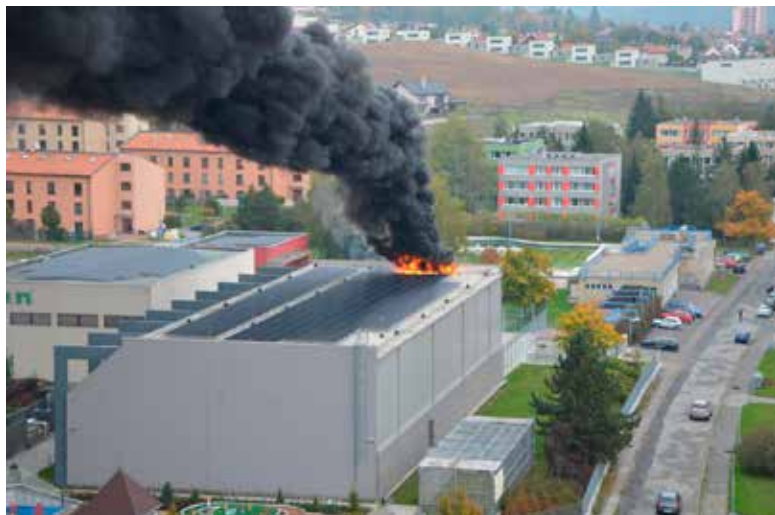
Požár FVE na střeše sportovní haly, Beroun, 12.10.2012, foto HZS Středočeského kraje
